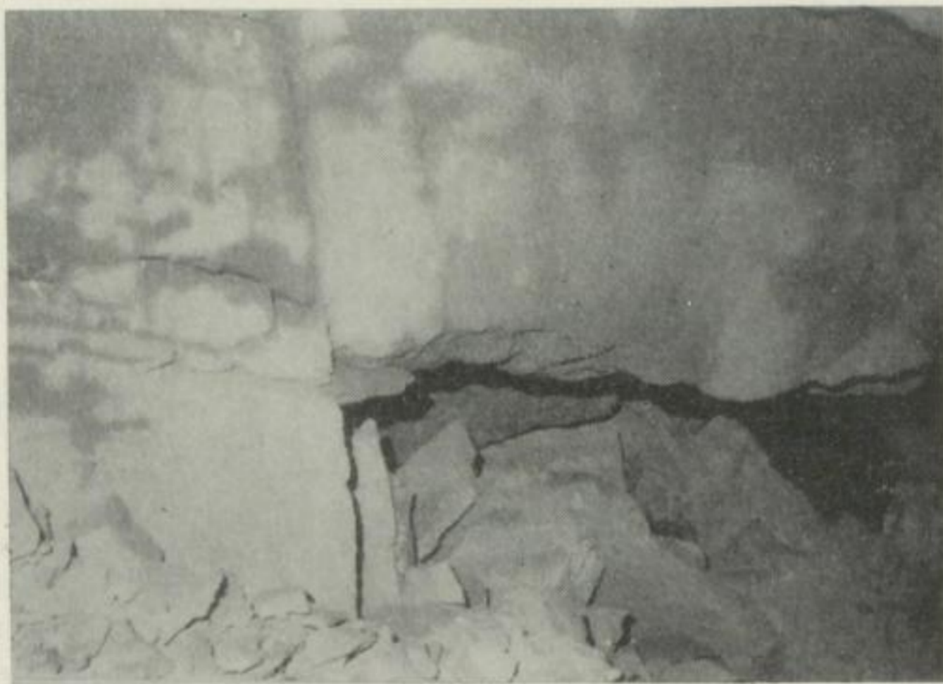
Abb. 24. Bruch im Abbau 353; deutlicher Einfluß der Schichtung
