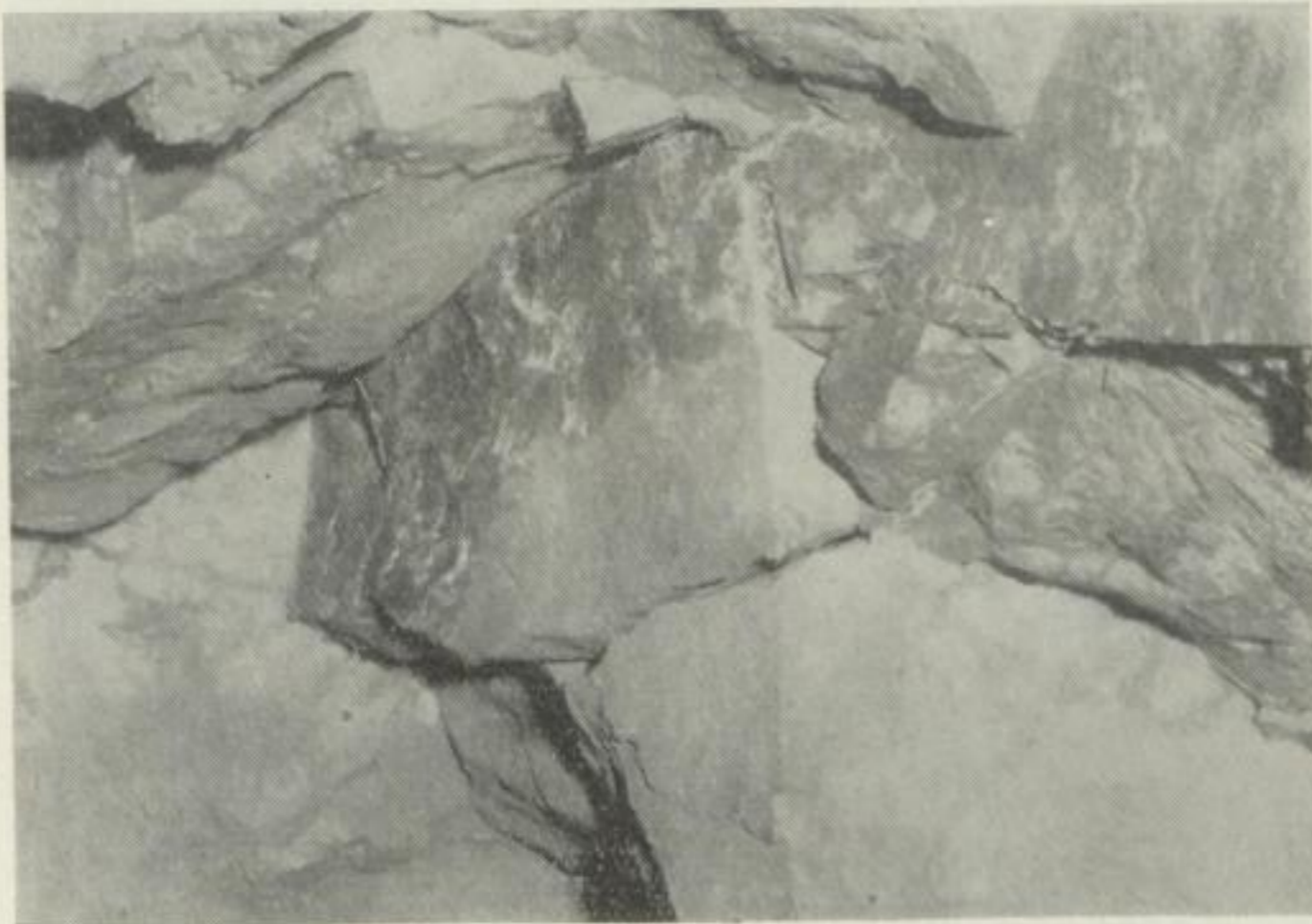
Abb. 9. Rißbildung und Ausbruch an der Brücke zwischen den Abbauen 231 und 232
