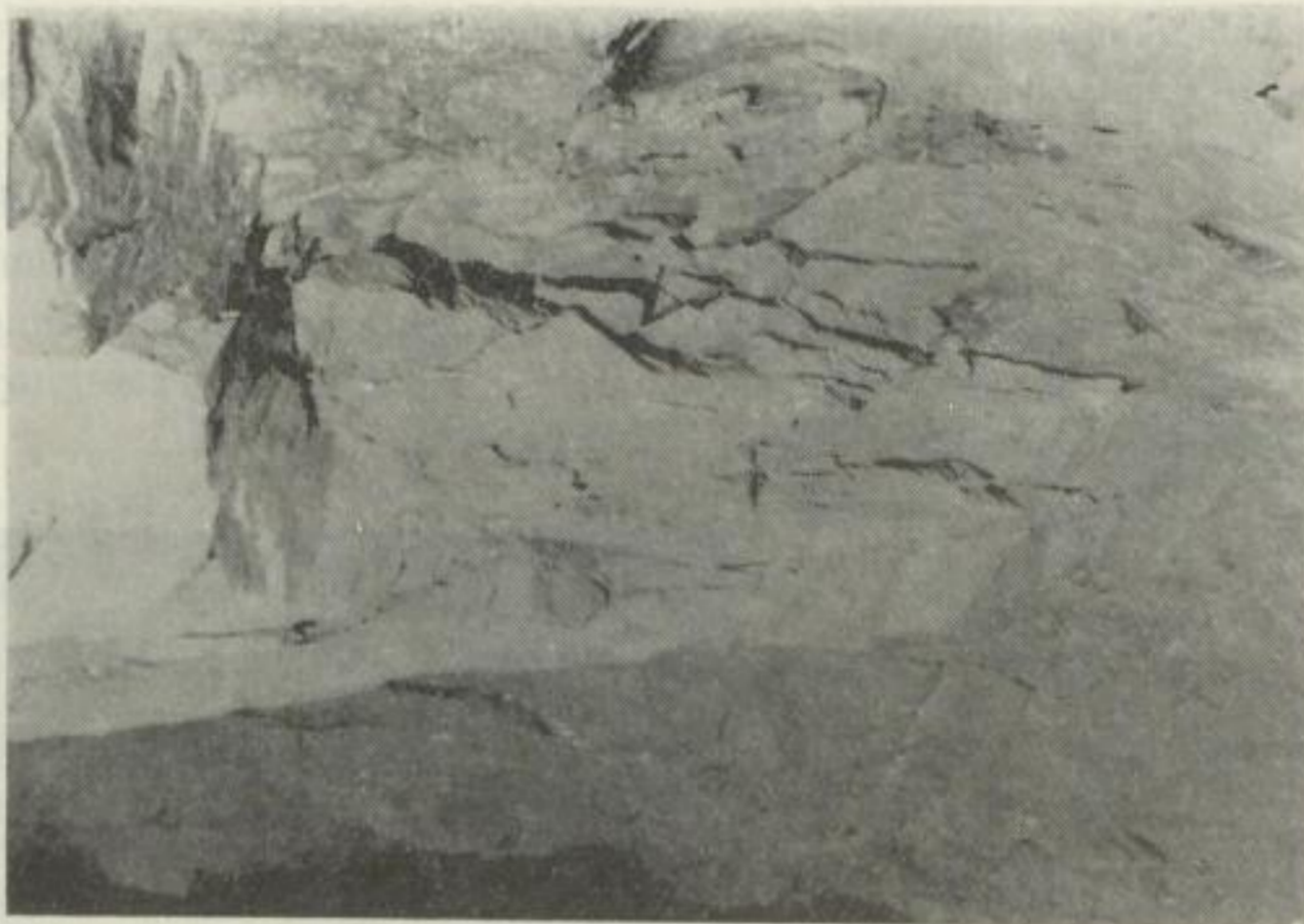
Abb. 19. Rißbildung in der Firste südlich des Pfeilers im Abbau 232
