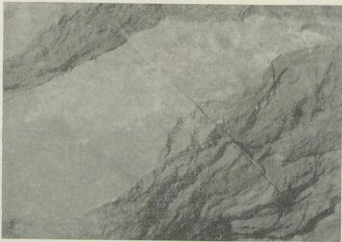
Abb. 8. Rißbildung an der Brücke zu den Abbauen 231 und 232 entlang einer mineralisierten Kluft
