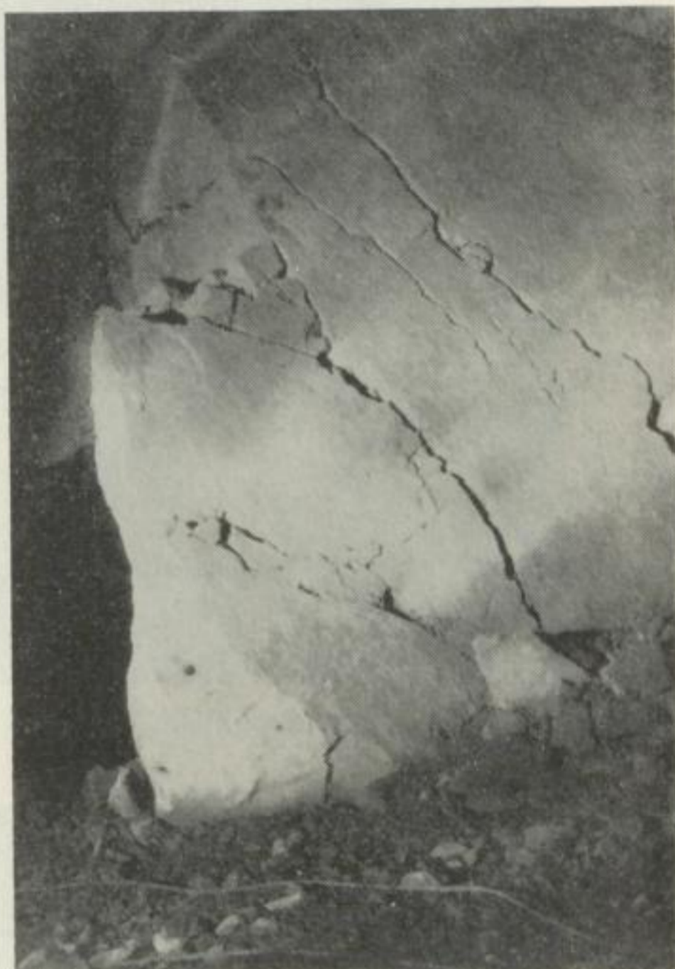
Abb. 18. Rißbildung in der NO-Ecke des Pfeilers im Abbau 232
