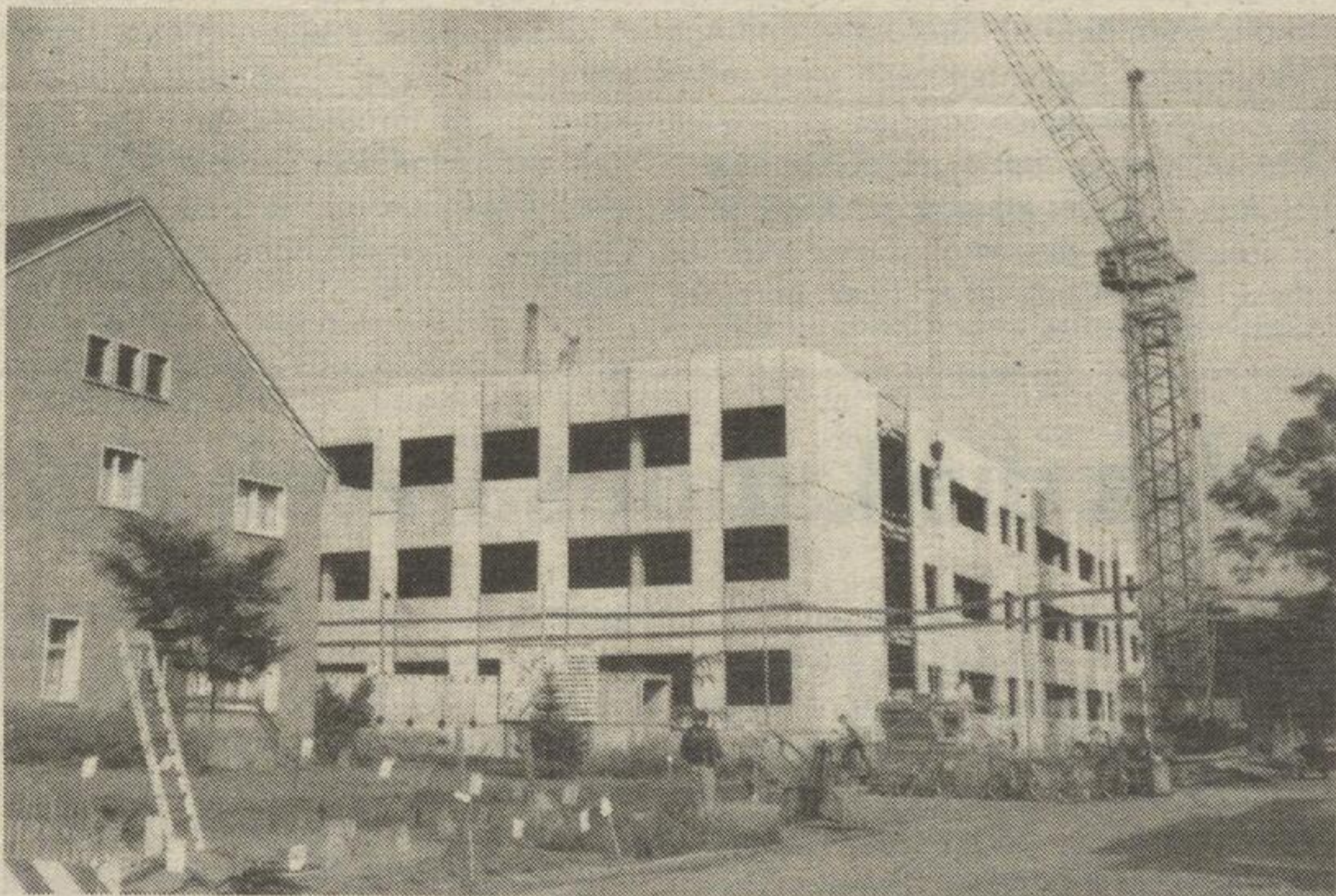
Das mittlere Foto entstand im September. Die Zierde der Richtkrone fehlt hier noch.
