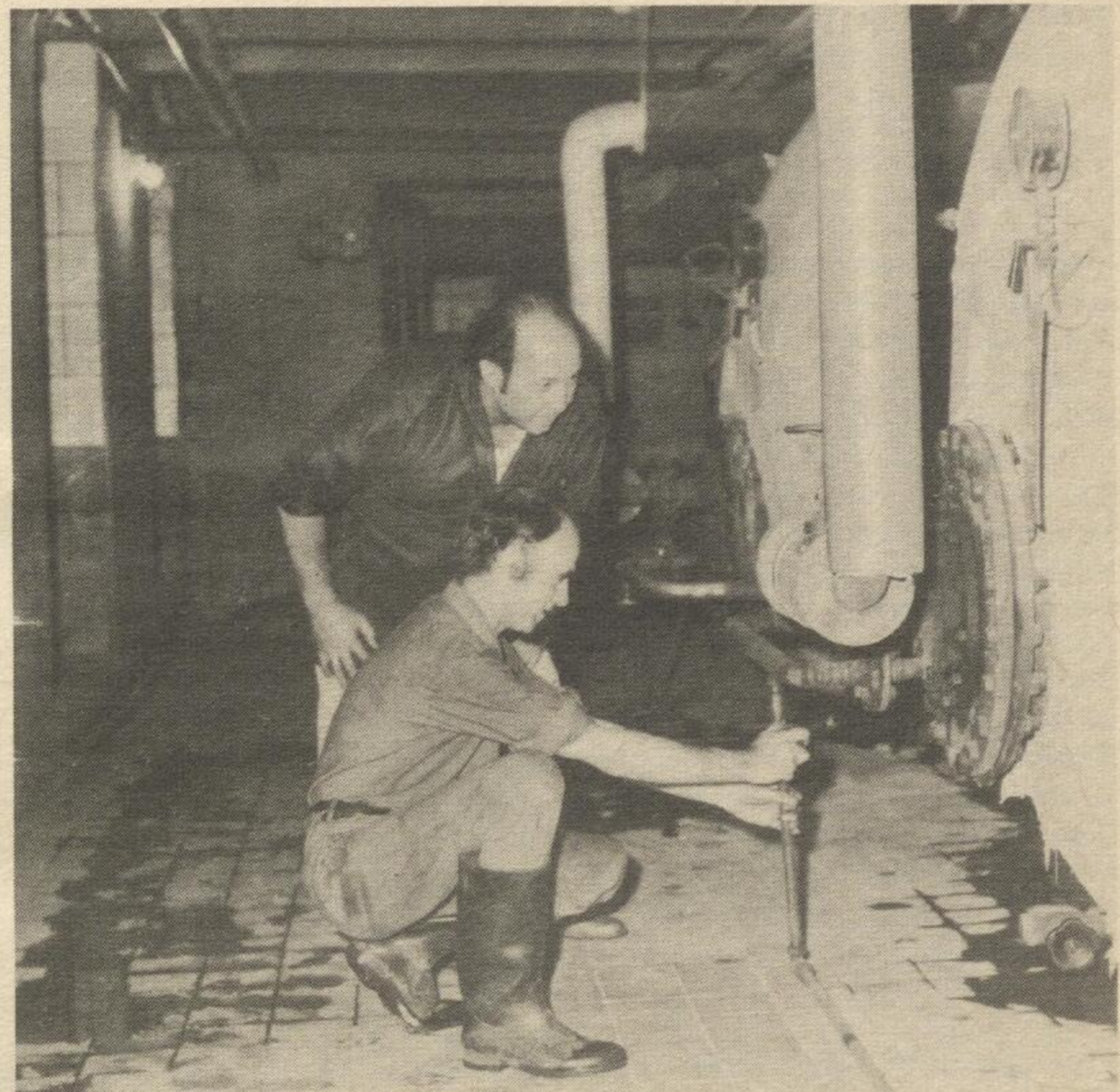
Genosse Werner Hofmann, Leiter der Abteilung Technik, und Kollege Karl-Heinz Halama, Heizer und Maschinist, in der Heizzentrale Altbau Foto: W. Bachmann
