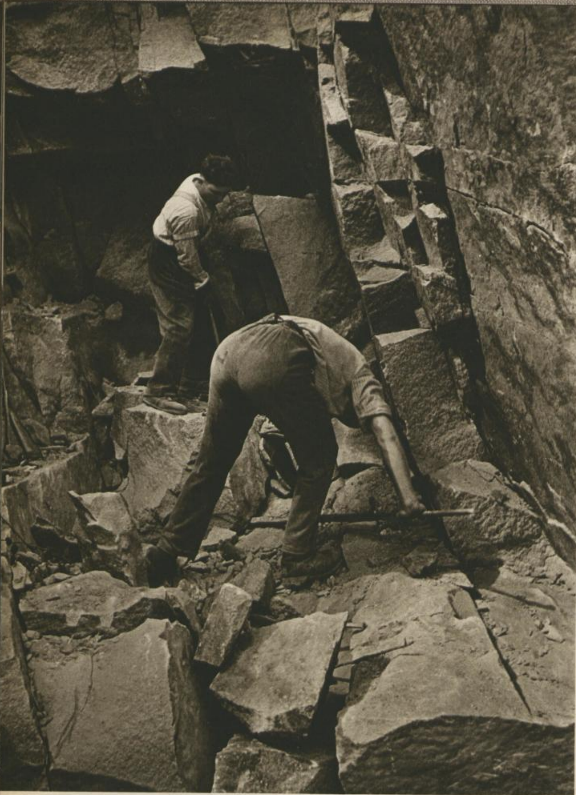
Urgestein, härtester Baustoff für Straßen und Pflaster, Brücken und Häuser — Menschenhände brechen, was für die Ewigkeit gefügt erschien. Granitbruch im Schwarzwald · Granite Quarry in the Black Forest · Carrière de granit dans la Forêt-Noire
