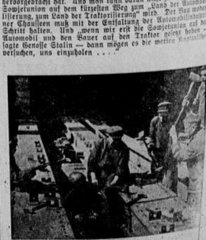
Die auf dem Neubau des Chemiekombinats in Beresnik beschäftigten deutschen Arbeiter aus Magdeburg arbeiten mit großer Begeisterung in einer Stochbrigade am sozialen Aufbau. Unser Bild zeigt die deutsche Arbeiterbrigade „Harding“ bei der Arbeit; vier von ihnen sind Mitglieder der
