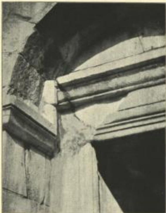
Abb. 1. Ecke der unteren Türe.
