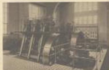
Zwei Deutzer Turbin-Dieselmotoren von zusammen 300 PS im Elektrizitätswerk Sanderhausen.
