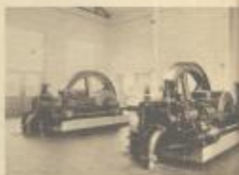
Zwei Deutzer Sauggasmotoren von je 100 PS in der Stromzentrale des Bahnhofs Wetzlar.
