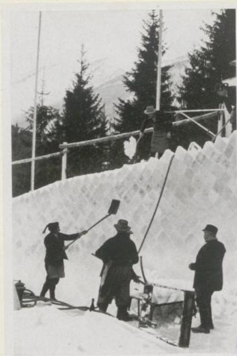
So entstanden die großartigen Kurven der Olympia-Bobbahn! Die Quadern aus dem Riessersee werden „zusammengeschweißt“.
