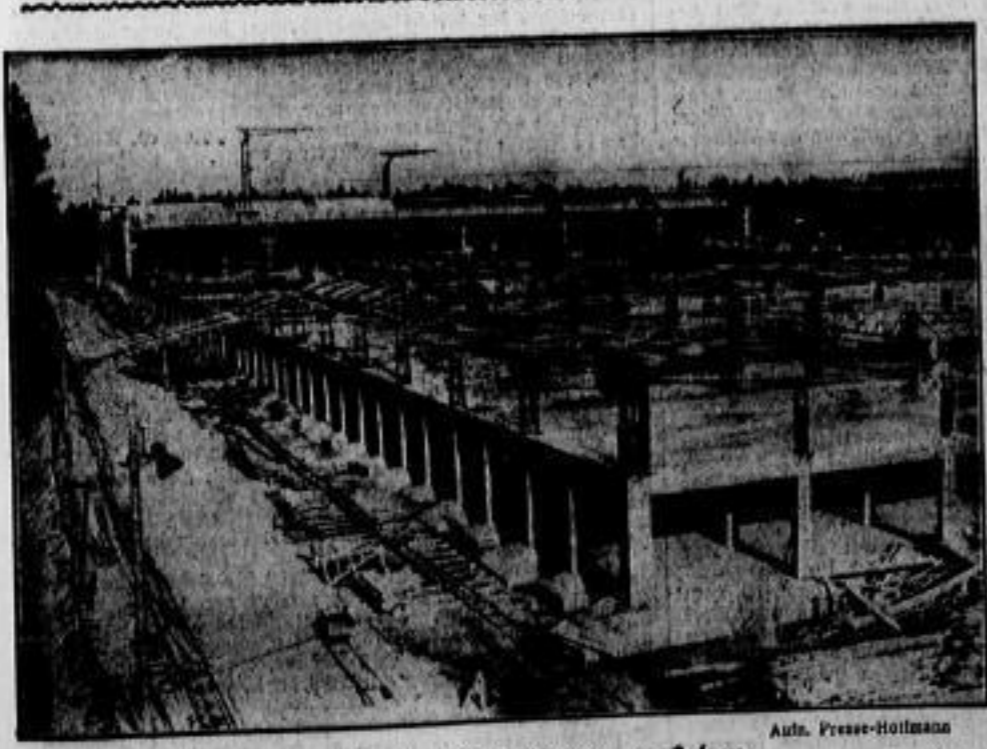
Hier wird der Vdg-Wagen entstehen Übersichtsbild von der Bauhütte der Volkswagenfabrik in Falkenberg
