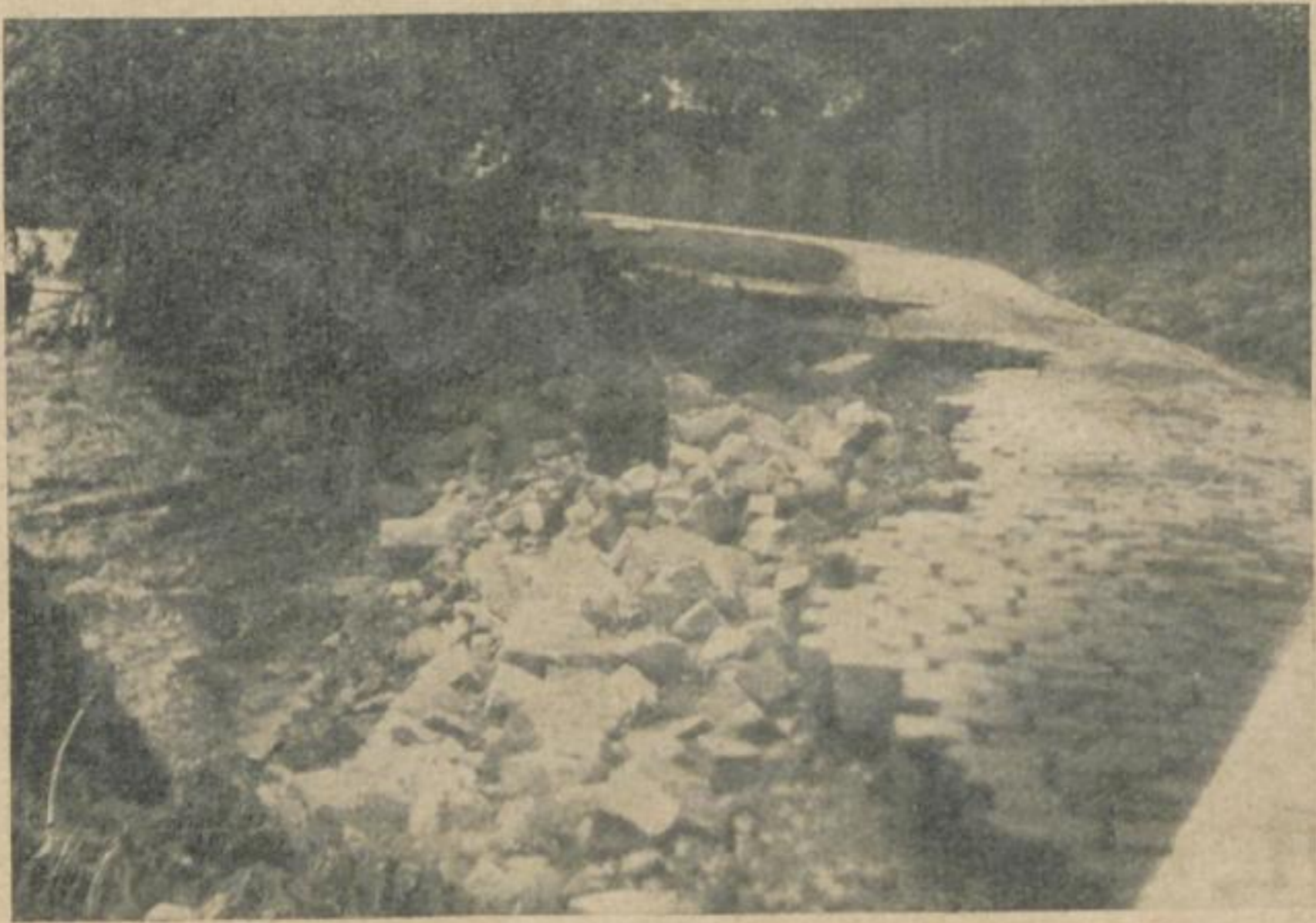
Schwarzenberg: Zerstörte Straße beim Wasserstoffwerk (Nach der Flut)
