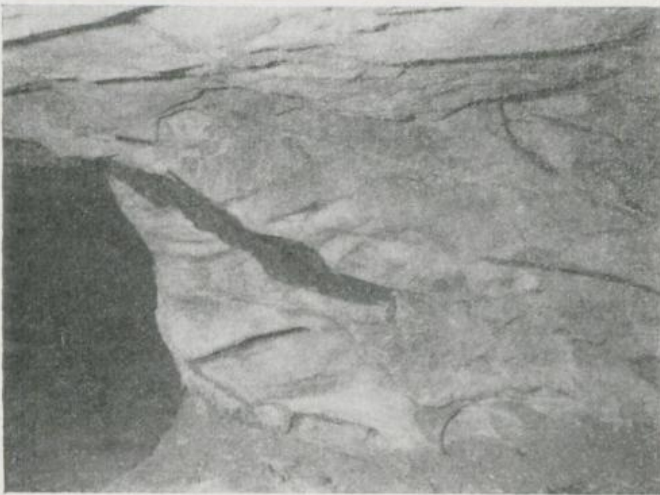
Bild 49 Gewölberiß auf Kali- werk „Friedenshall“, Bernburg
