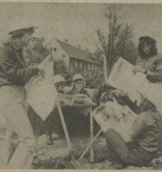
In der Frühstückspause auf der Baustelle der Technischen Gebäudeanstalt bleibt auch Zeit, einen Blick in den neuesten „Hochschulspiegel“ zu werfen.
