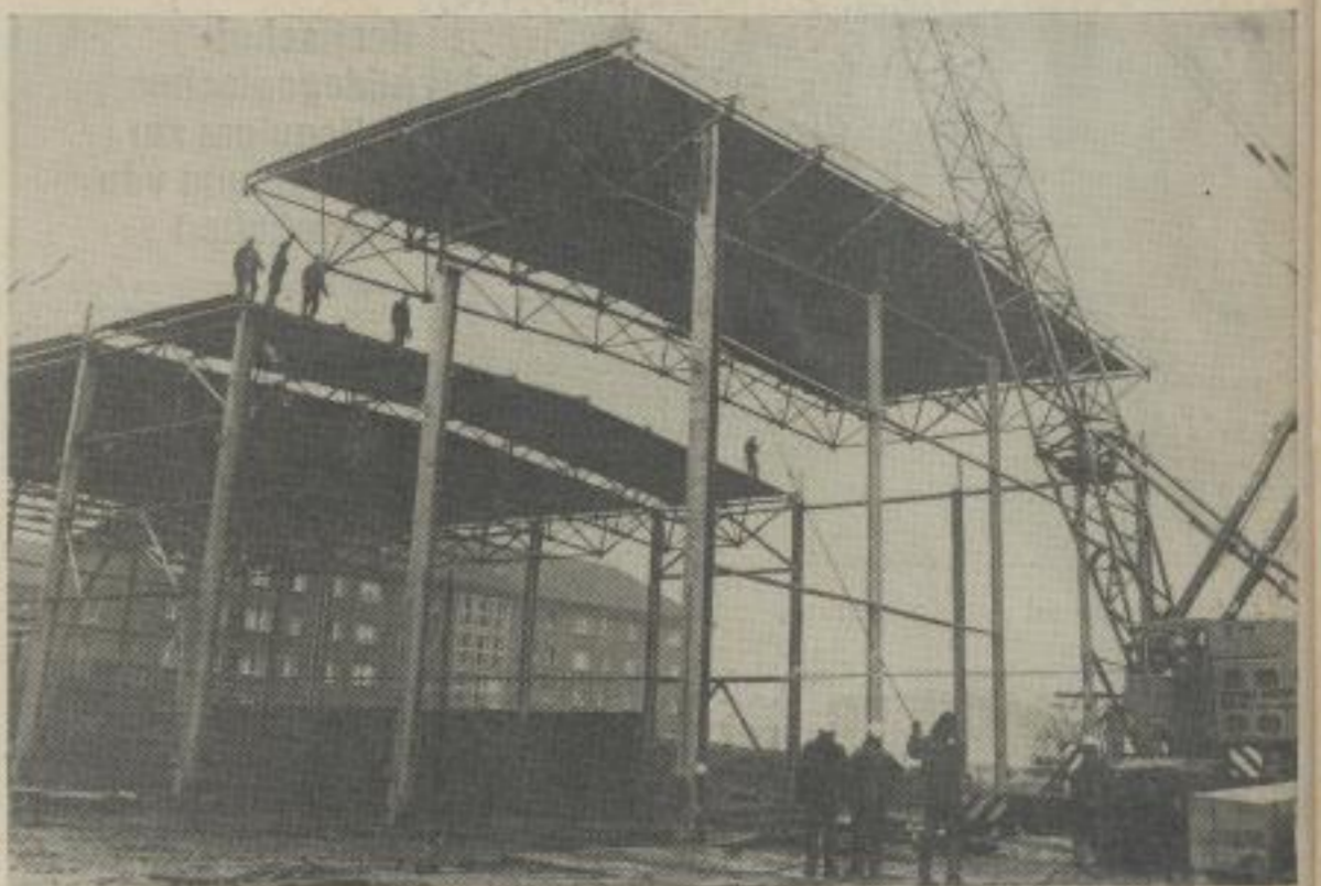
Im Zuge der Weiterführung des Sporthallenbaus konnten Mitte Dezember die Stabnetzwerke montiert werden. Mit dieser Montage wurden die Voraussetzungen für den weiteren Ausbau der Halle geschaffen.
