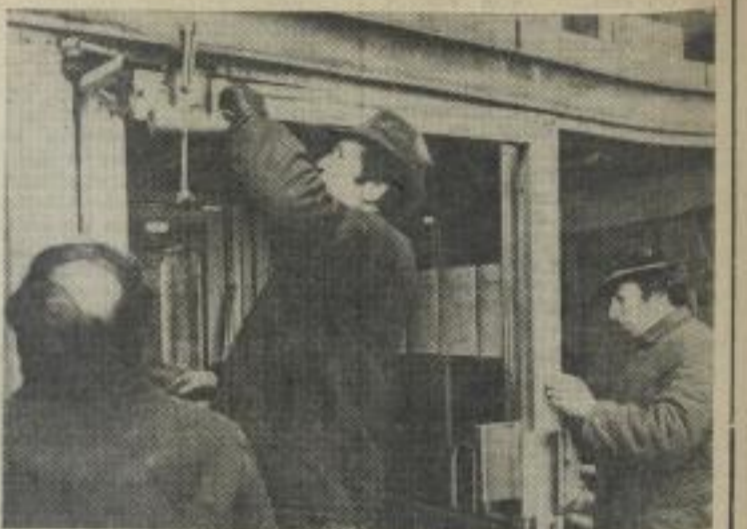
Bei den an unserer Hochschule zu bewältigenden Reparaturarbeiten erhalten die Mitarbeiter des Sektors Bautechnik tatkräftige Unterstützung von Handwerkern aus den Sektionen.
