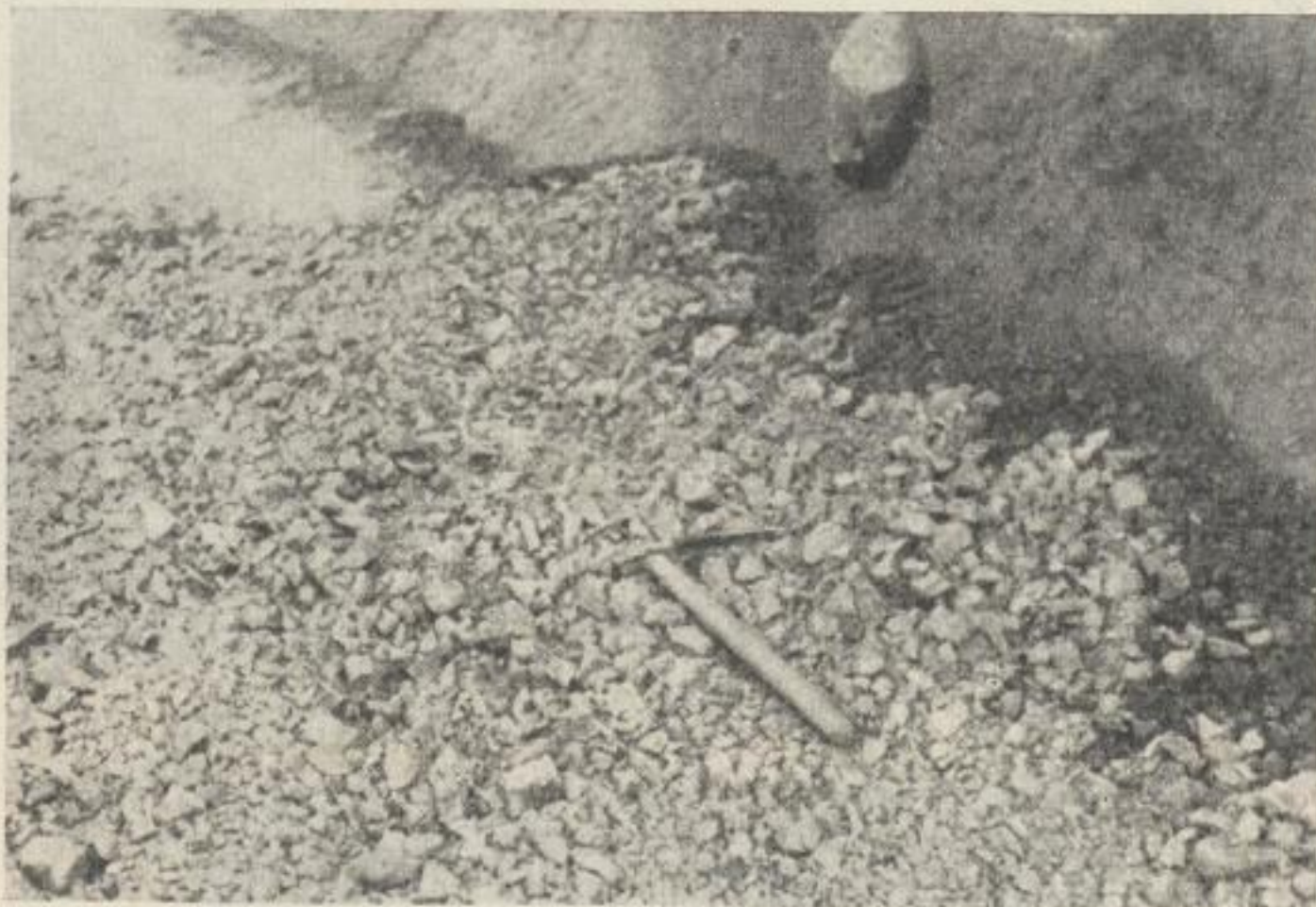
Bild 18. Zerfall des zerrütteten Geschiebemergels bei Verwitterung
