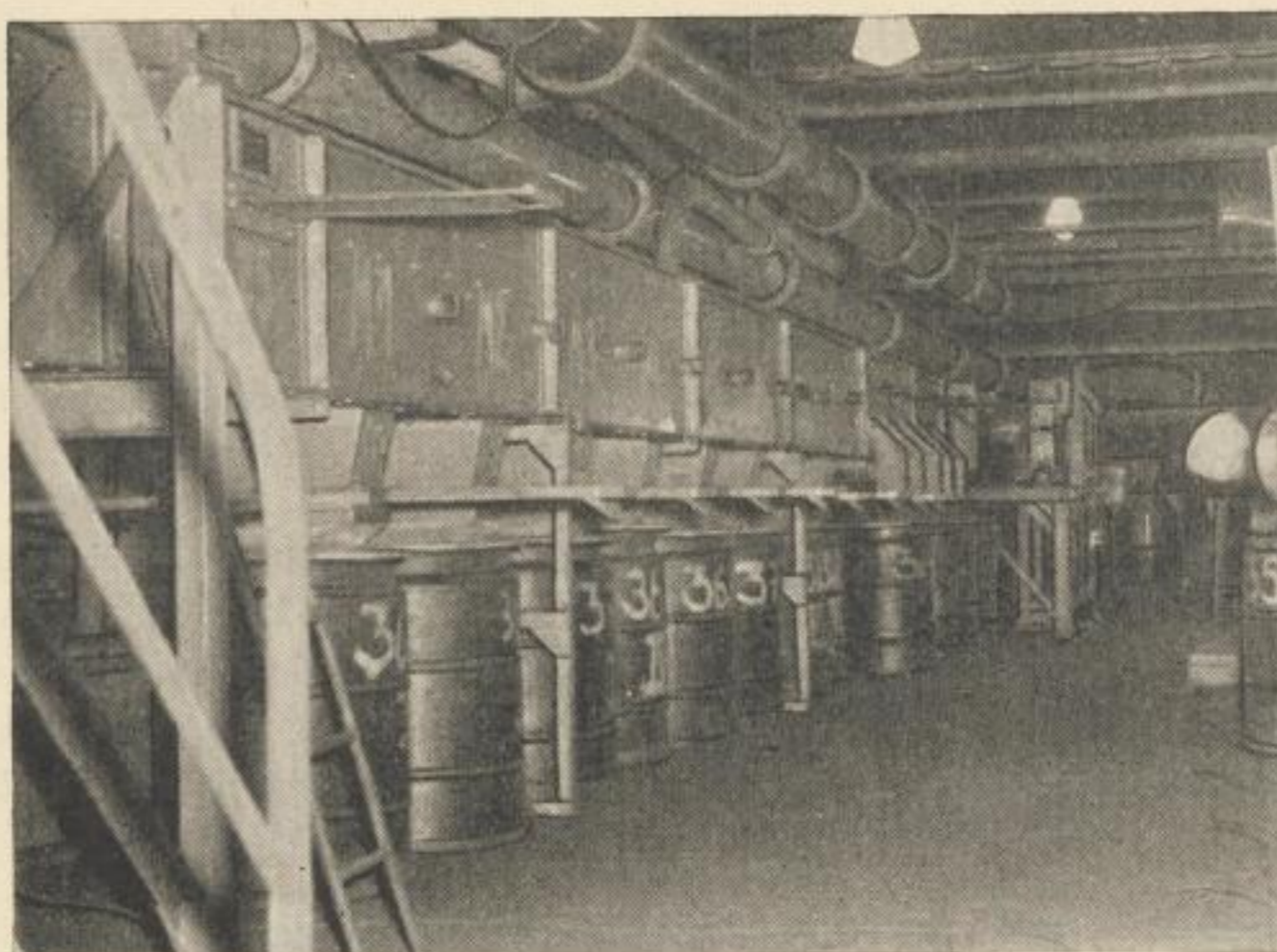
Bild 2. Gesamtansicht des Siebkettenförderers von der Aufgabeseite
