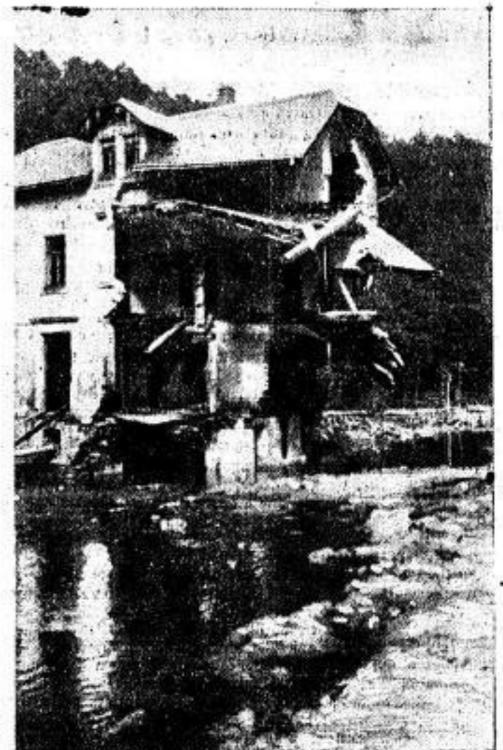
Zerstörtes Wohnhaus in Glashütte.
