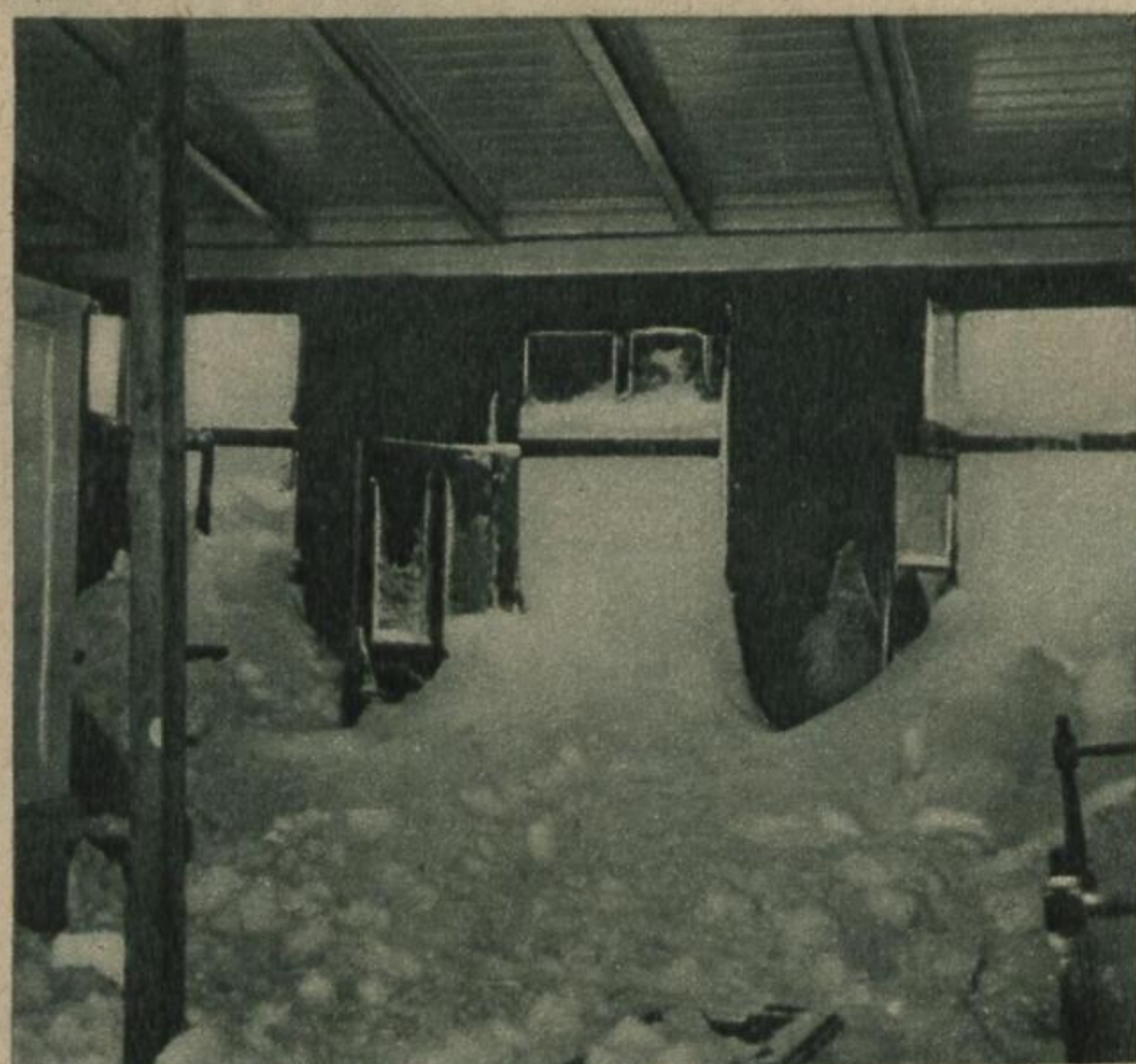
Schwere Lawinenfälle gingen in den letzten Wochen an der Arlbergbahn zwischen Innsbruck und Bludenz nieder. Besonders hart wurde die Haltestelle Langen betroffen. Der Schnee der Lawinen drang durch Fenster und Türen in das Bahnhofsgebäude ein (oben). — Die Bahnhofshalle wurde eingedrückt und das herabstürzende Dach brachte mit seinen Schneemassen auch die Eisenbahnwagen zum Umkippen (rechts) E. B. D.
