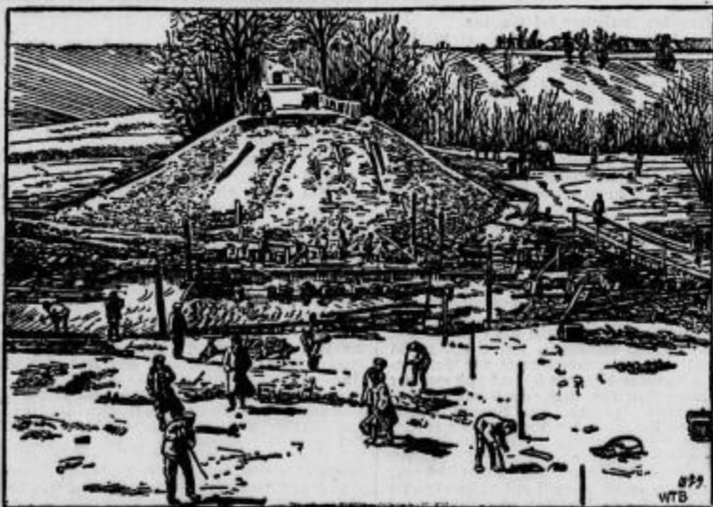
Wiederherstellung der von den Russen verbrannten Chausseebrücke bei Skrudville in der Nähe von Libau.
