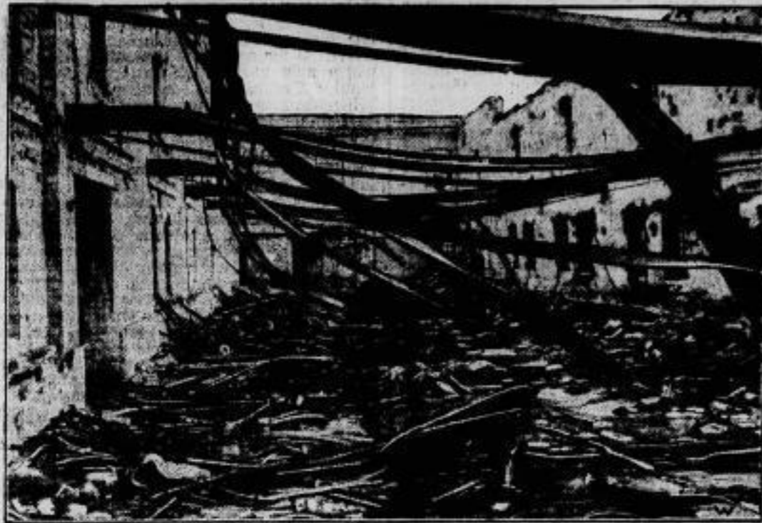
Chemische Fabrik Calbe a. S. vollkommen eingeebnet. In der Chemischen Fabrik Calbe brach durch Kurzschluss oder Beschleusen eines Transformators ein Großfeuer aus. Das ganze Fabrikgebäude brannte in 2 Stunden vollkom-
