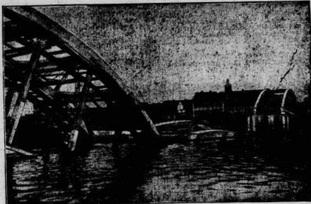
Der Garper Brückensturz. Im Vordergrund der durch den Wegbruch des Pfeilers gesunkene erste Brückenbogen. Mittelbogen und Pfeiler sind im Strome versunken. Im Hintergrunde die Stadt Garz.
