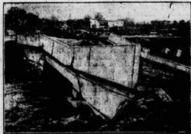
Einbruch der Havelbrücke bei Liebenwalde.
