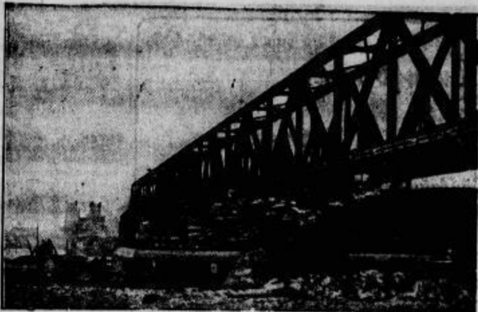
Der Bau der neuen Rheinbrücke bei Mainz, der seit geraumer Zeit im Gange ist, ist erheblich fortgeschritten.
