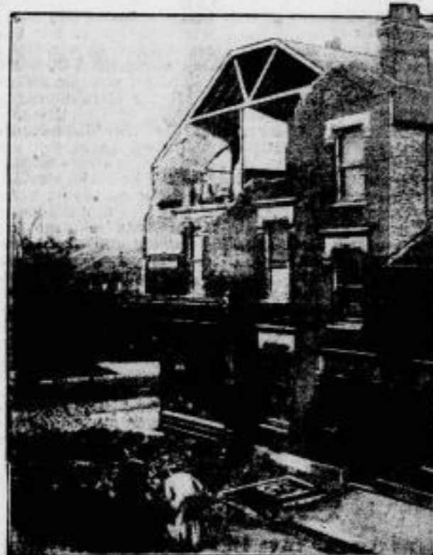
Sturmverwüstungen in London. Ein über England wütender Orkan hat besonders London heimgesucht und dort die Giebelwand eines Hauses eingedrückt, von deren Trümmern zwei Personen erschlagen wurden.
