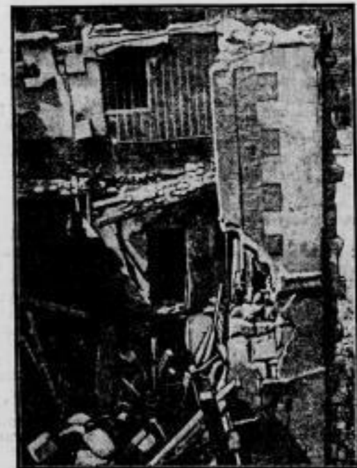
Gauleinsturz in Paris. In Paris stürzte kürzlich ein sehr altes Wohnhaus beim Abbruch plötzlich ein und begrub drei Arbeiter unter den Trümmern. In unserem Bilde sieht man die Rettungsarbeiten der Feuerwehr.
