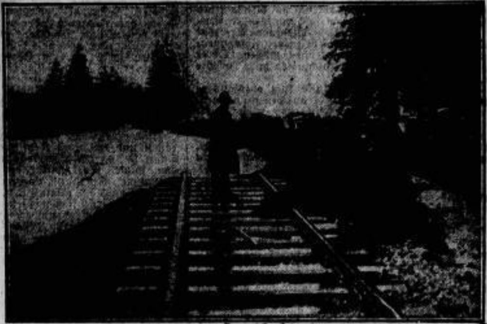
Im Hartz. Auch der Hartz hat schwer zu leiden. Von der Gewalt der Fluten gibt unsere Aufnahme einen Eindruck. Der Bahndamm der Strecke Goslar-Lautenthal-Clausthal im Hartz wurde völlig unterpült und ist zum Teil eingestürzt. Der Verkehr wird durch Autobusse aufrecht erhalten.
