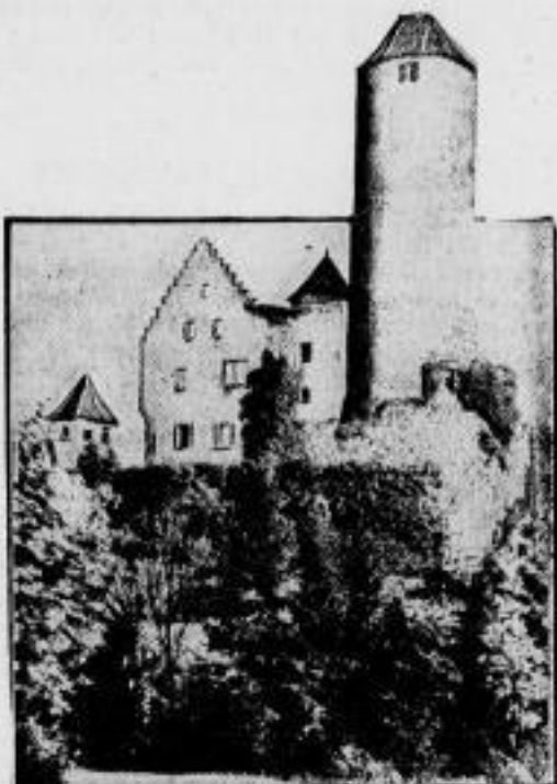
Blitzschlag in die Burg Goh von Verlichingen. Die Burg Goh von Verlichingens mit der Eisernen Hand, Burg Hornberg a. N., wurde kürzlich durch Blitzschlag schwer beschädigt, so daß bis auf weiteres das Gebäude abgesperrt werden mußte, da Einsturzgefahr besteht.
