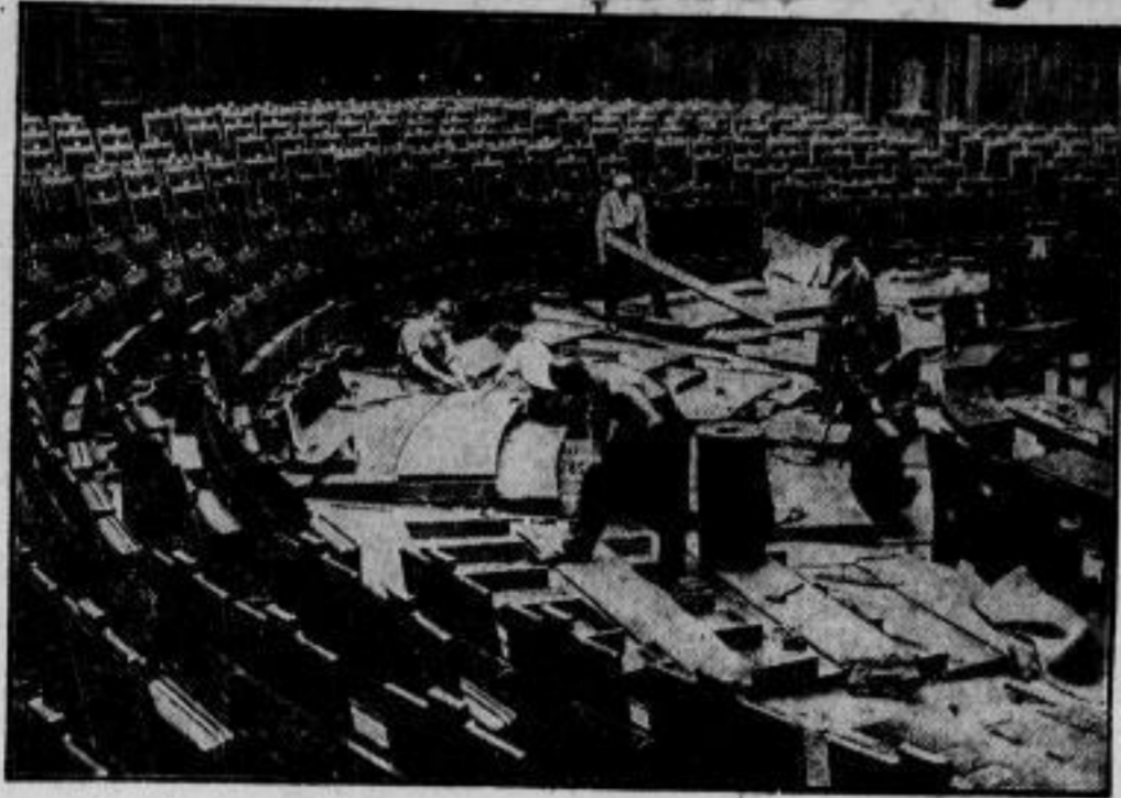
Der Reichstag muß vergrößert werden. Nachdem jetzt die erste Sitzung des neu gewählten Reichstages auf den 30. August festgesetzt worden ist, wird im Sitzungssaal des Reichstages eifrig am Einbau neuer Sitze gearbeitet — ist doch die Zahl der Abgeordneten auf 608 gestiegen!
