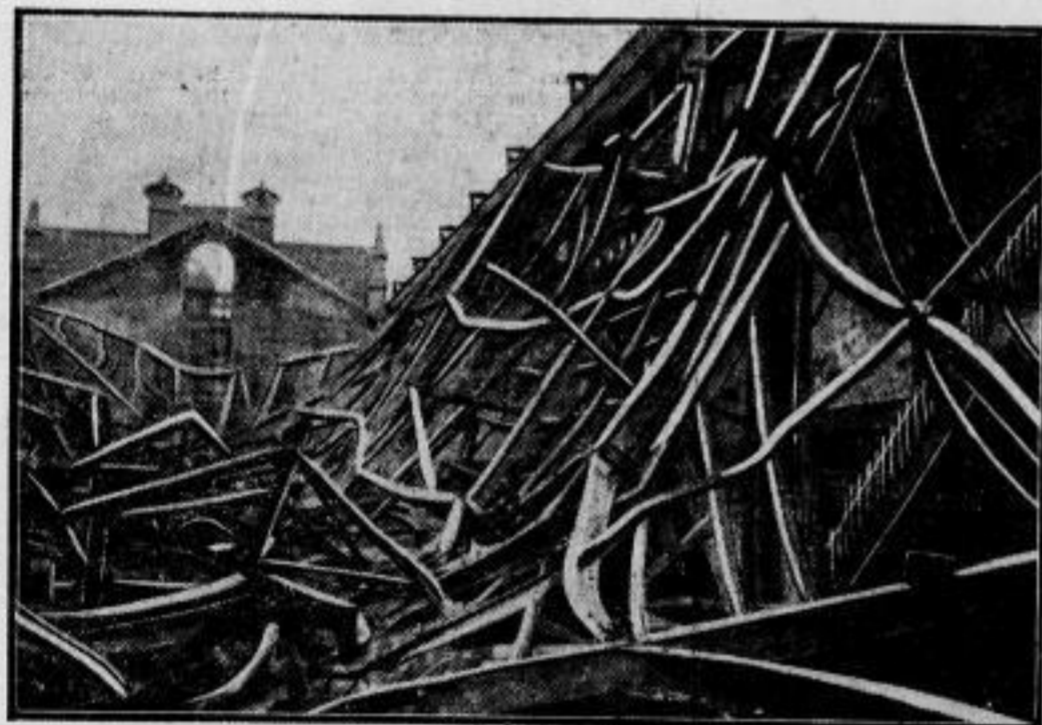
Das Elektrizitätswerk von Brüssel niedergebrannt. Das Elektrizitätswerk der Stadt Brüssel wurde von einem verheerenden Schadenfeuer heimgesucht, das fast sämtliche Maschinenanlagen zerstörte. Durch den Brand war die Stadt mehrere Stunden ohne Licht, und auch jetzt noch leidet das gesamte Wirtschaftsleben Brüssels durch die fehlende Stromversorgung. Die unser Bild zeigt, bietet der Maschinenaal des Werkes ein Bild der Verwüstung.
