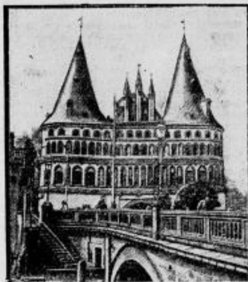
Das Lübecker Holstentor in Gefahr. Eines der bedeutendsten Baubauwerke Deutschlands, das Holstentor in Lübeck, soll in erster Gefahr sein: im Innern hat man starke Risse festgestellt, und die beiden Türme, die auf hölzernen Pfählen in schlammigem Grunde stehen, haben sich bereits stark geneigt. Es soll zu befürchten sein, daß der baufällige Stiel einstürzt.
