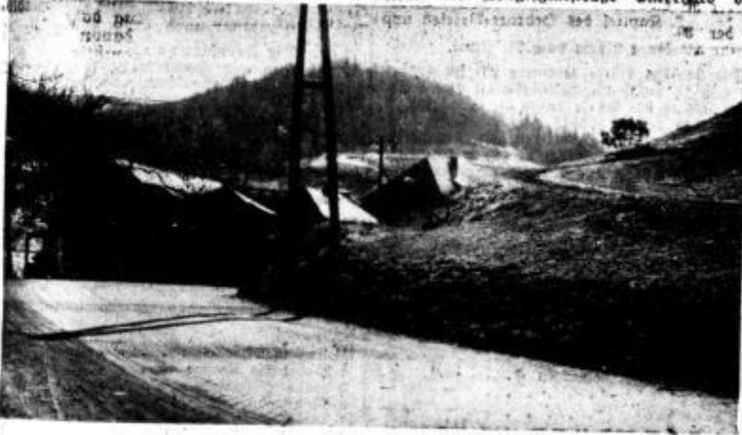
Bild 1 zeigt den ursprünglichen unübersichtlichen Kurvenzustand talaufwärts mit breiter Böschungsbänke und steilgelagertem Felsbuckel hinter der das Blickfeld störenden Telegraphentange. Für den doch gleichberechtigten Fußgänger war gegenüber kurvenschneidenden Kraftfahrern keinerlei Schutz vorhanden.
