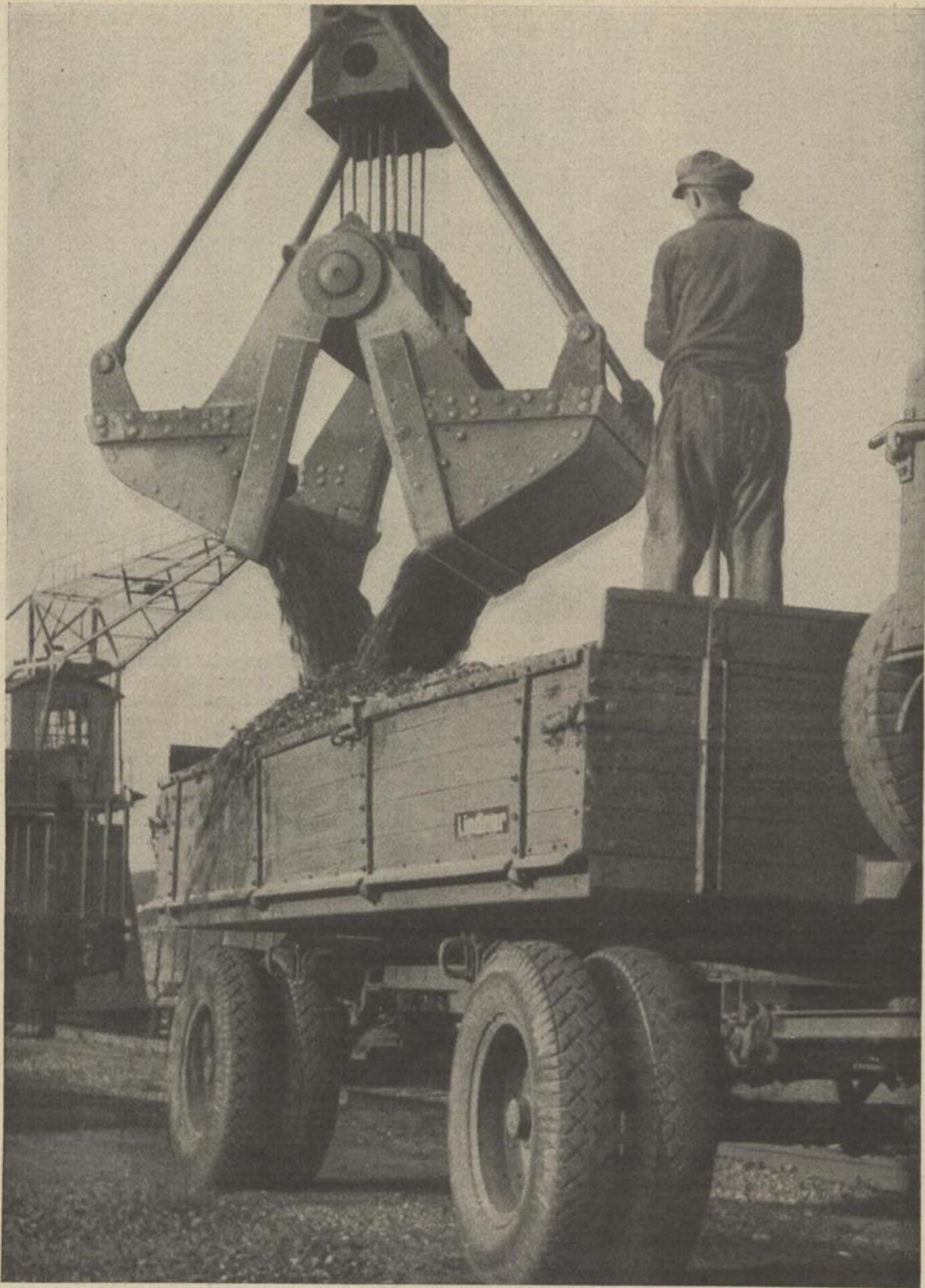
Bild 193. Bei der Arbeit. Eine bildmäßig erwünschte Bewegungsunschärfe der herabfallenden Erde vermittelt den Eindruck der Bewegung. Karl Taube †, Leipzig
