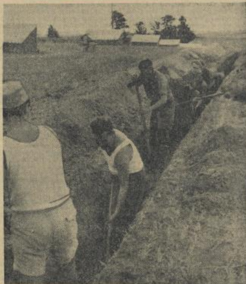
„Hier arbeitet die Brigade Drei“, sagt ein großer junger Mann und stemmt die Schaufel fest in den feuchten Sand. Wie ein dunkler Streifen zieht sich der tiefe schmale Graben, den zehn fleißige Burschen ausheben, mitten durch den sonnigen Auslauf einer Junghühnerfarm. „Wir bauen hier eine Wasserleitung für das Kesselhaus der LPG Badrina. Unsere Norm haben wir bis jetzt überboten.“
