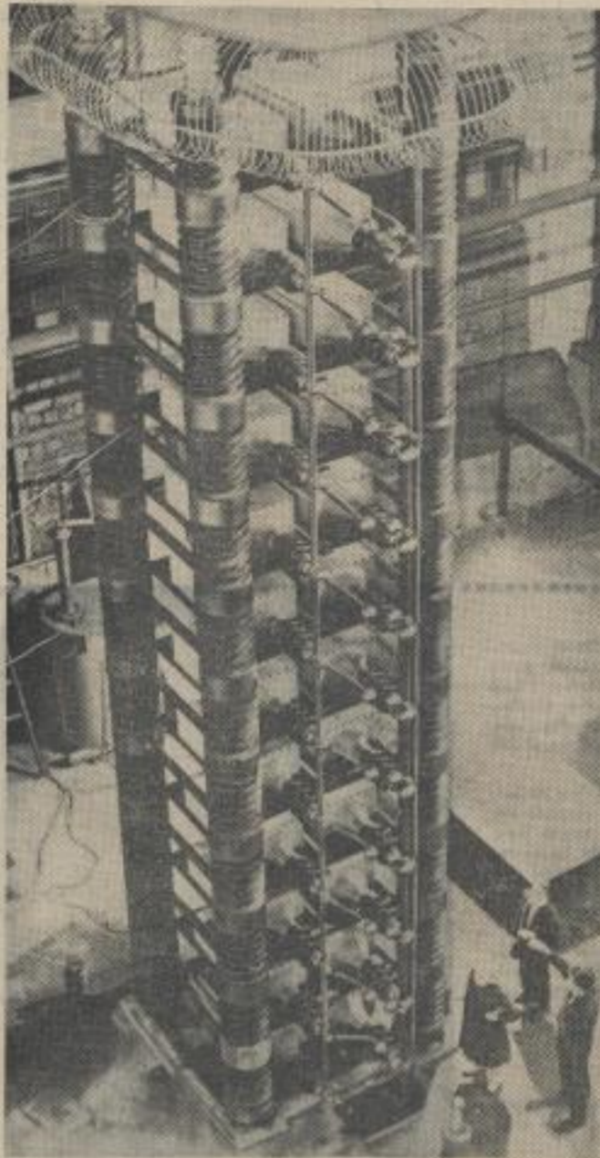
Ein mächtiger Generator für Impulsspannungen von 2 600 000 Volt - Ende des vergangenen Jahres im Sverdlowsker Forschungsinstitut für Elektrotechnik in Betrieb gesetzt. Foto: ZB/Nowosti
