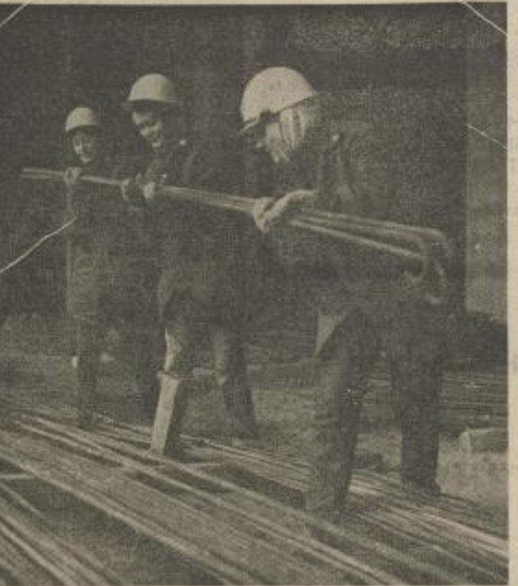
Seit einiger Zeit arbeiten im „Rollenden Studentensommer“ am Universitätsneubaukomplex Studenten der Sektion TAS. Sie übernehmen Abblöde und Transportarbeiten am Holzplatz, beim Innenausbau und bei Außenarbeiten an der Fassade unterstützen sie die Bauarbeiter. Gegenwärtig arbeiten über 40 Studenten der Sektion TAS auf dem Bau am Karl-Marx-Platz. Auf unserem Foto - Studenten des 3. Studienjahres beim Transport von Bewehrungsseilen. Foto: Raschke
