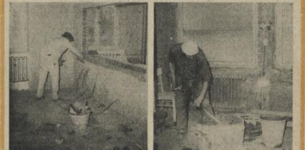
Einer gründlichen Rekonstruktion wird gegenwärtig die Bettenstation der Stomatologischen Klinik unterzogen. Bis Ende Februar sollen mehrere Zimmer wieder zur Nutzung übergeben werden. Fotos: UZ/Fischer - HFBS/Aschenbrenner
