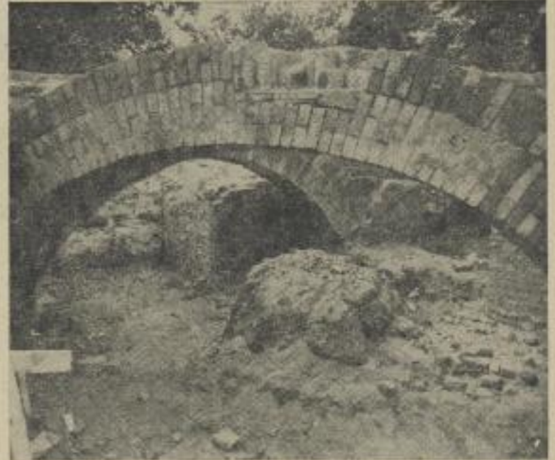
Diese Mauerbögen sind typisch für die gesamte Basteianlage. Hier ein Blick auf den Toilettentrakt im „Urzustand“.
