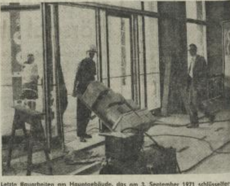
Letzte Bauarbeiten am Hauptgebäude, das am 3. September 1971 schlüsselfertig übergeben wurde. Foto: UZ/Archiv
