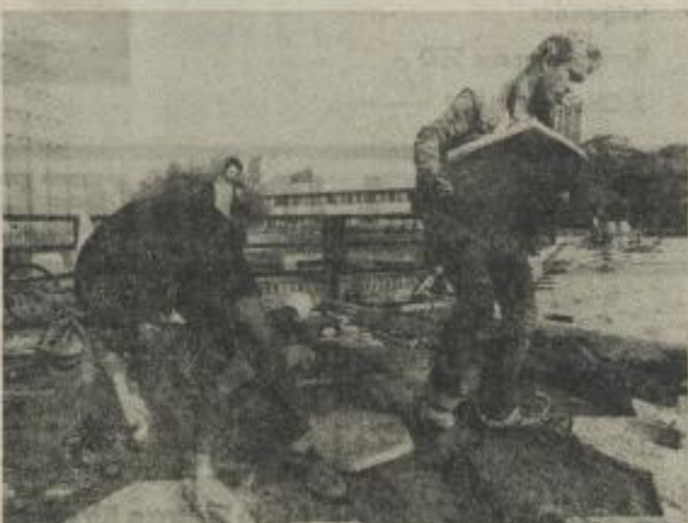
Am Jugend- und Studentenzentrum „Moritzbastei“ gehen die überirdischen Bauarbeiten weiter. Kollegen vom VEB Baureparaturen Leipzig-Mitte verlegen kürzlich Platten für die Terrasse des historischen Gebäuers. Foto: Michael Hübner
