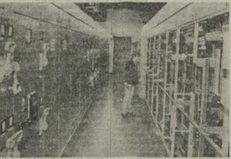
In der Schwerpunktsstation. Hier laufen die Fäden der Energieversorgung für Zentralmensa und Seminargebäude zusammen.
