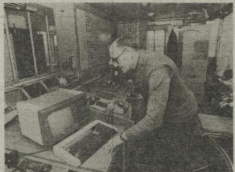
MODERNE TECHNIK IM TAGEBAU. Ein Mikrorechner und ein Monitor komplettieren seit Anfang dieses Jahres die Steuer- und Leittechnik am Leitstand der Abraumförderbrücke im Tagebau Meuro des BKK Sanftenberg. Rechnergestützt verlaufen bei dieser Komplexautomatisierung die technologische Vorbereitung, Betriebsführung und Kontrolle der Brückenfahrweise. Foto: ADN/ZB
