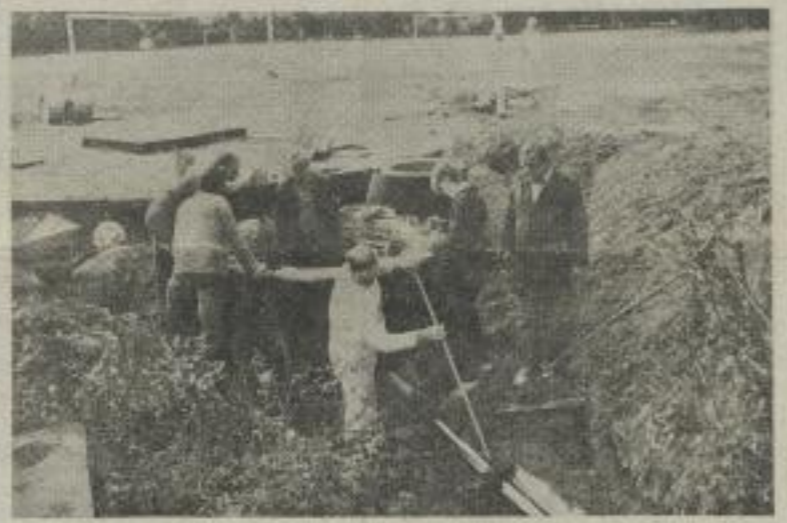
Kollegen der Betriebstechnik Naturwissenschaften beim Anschluß eines Sanitärtraktes an eine Kläranlage an der Wettinbrücke. Das Kollektiv erarbeitete mit seiner Friedenschicht einen Nutzen von über 14 000 Mark. Foto: HFBS/ENGL
