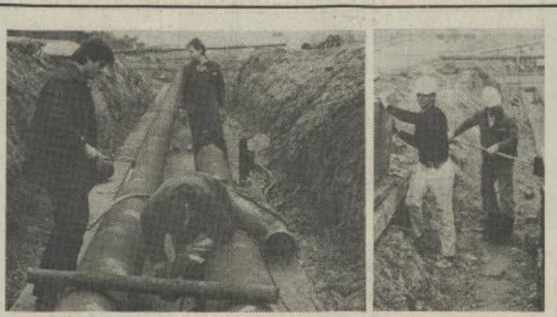
STABILISIERUNG DER WÄRMEVERSORGUNG AM BE- REICH MEDIZIN DER KMU. Während Heinz Beier (Bri- gadier), Thomas Kaschik (links) und Lutz Krüger (hinten rechts) vom Betrieb TGA Leipzig Rohre der Fernwärme- trasse zusammenschweißen, arbeiten Brigadier Andreas Wisdich (rechts), Heiko Schön (links) sowie weitere Werkkräfte aus dem VEB VTK Leipzig, KB V am Einbau der Rohre. Text und Foto: Batbed Sereeter
