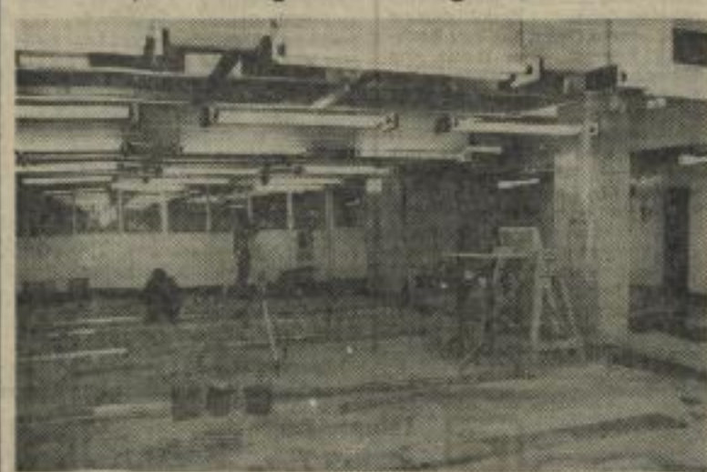
(UZ) BAUREPORT BETRIEBSTECHNIK STADTMITTE. Wichtigste Baumaßnahmen in der Küche der Zentralmensa sind zur Zeit die Arbeiten der Fliesenleger. Sie sind Voraussetzung für den Einbau der neuen Küchengeräte, der am 27. Juli beginnt. Alle Bauarbeiten verlaufen planmäßig und termingemäß. Foto: HFBS (Kranich)
