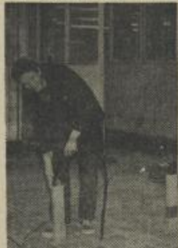
Der bauleitende Monteur, Jörg Veitel, entfernt die Bauschutzrohre von den elektrischen Zuleitungen für die Küchengeräte.
