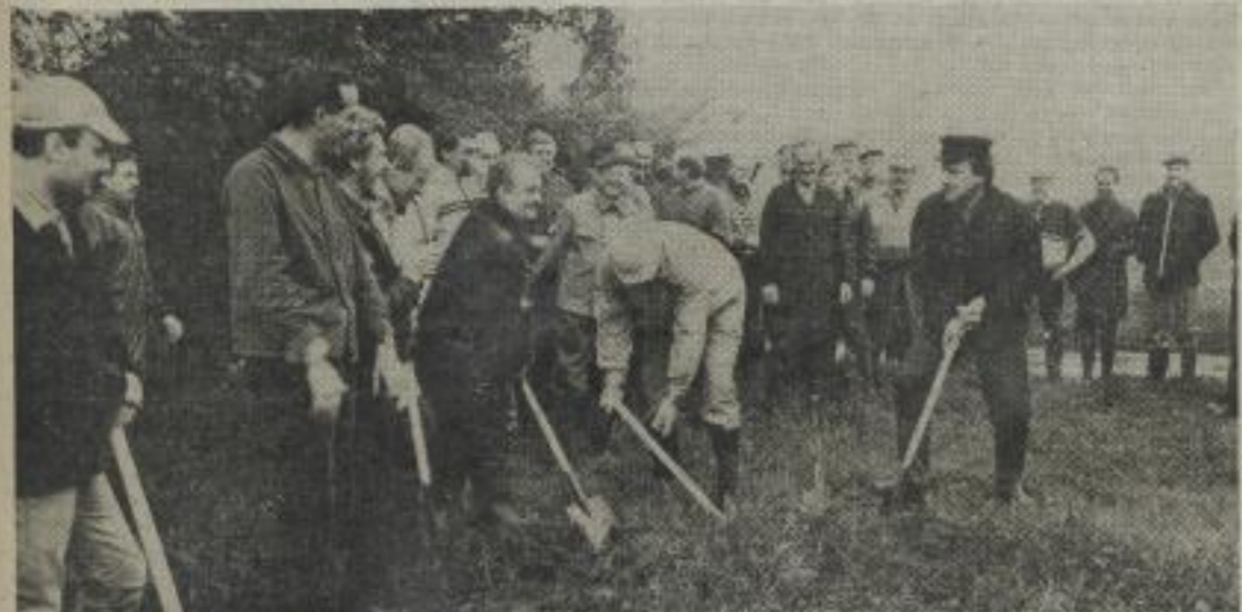
Der erste Spatenstich an der Fernwärmetrasse wurde gemeinsam vom Rektor, Genossen Prof. Dr. Manfred Krauß (rechts), und dem Hauptdirektor des ITVK, Genossen Dr. Sieber (mit Helm), getan. Beim Auftakt am 2. Juni 1987 waren weiter dabei die Genossen Dr. Horst Geißler (4. von l.), stellvertretender Sekretär der ZPL, Dr. Henry Knorr (5. v. l.), Vorsitzender der UGL, Gunter Stoll, 1. Sekretär der FDJ-Kreisleitung, Prorektoren, Sektionsdirektoren und Funktionäre aus den Sektionen (siehe auch Seite 2).
