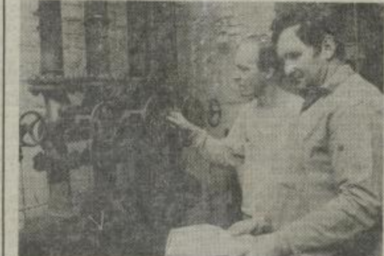
In der Umformstation trafen wir bei einem Fachgespräch den Bauleiter Gerd Rudolph (l.) vom Direktorat Technik und Jürgen Berth von der PGH Zentralheizungsbaue.
