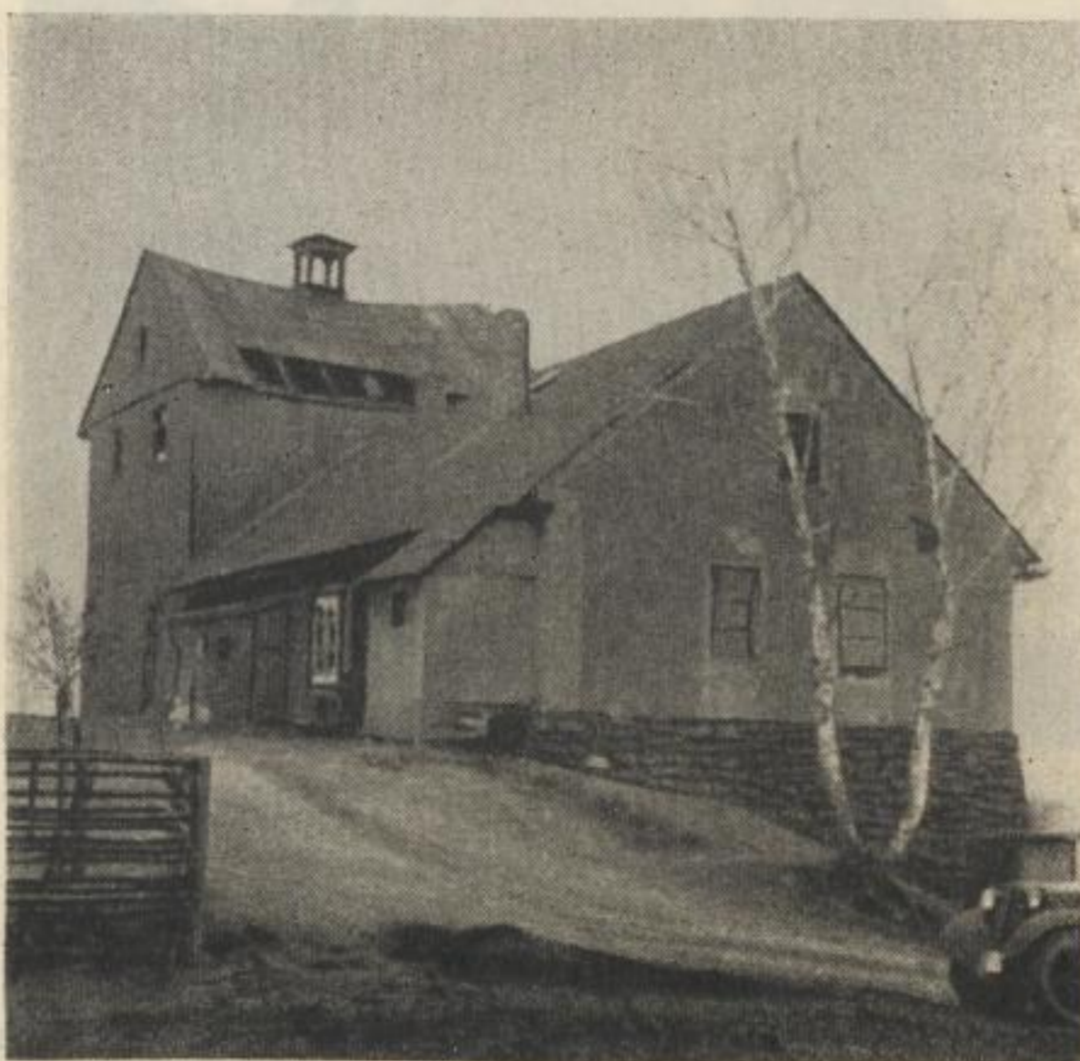
Bild 126. Treibehaus der Grube Christbescherung bei Großvoigtsberg mit schadhaftem Dach (Photo: März 1954)
