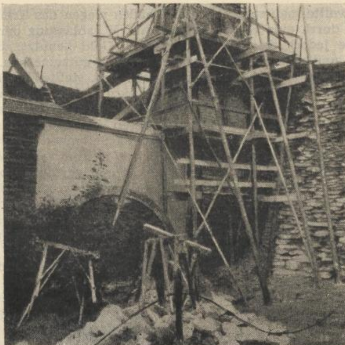
Bild 125. Fuchs und Schornsteinsockel der Grube Alte Elisabeth bei Freiberg während der Wiederherstellung (Photo: Sept. 1955)
