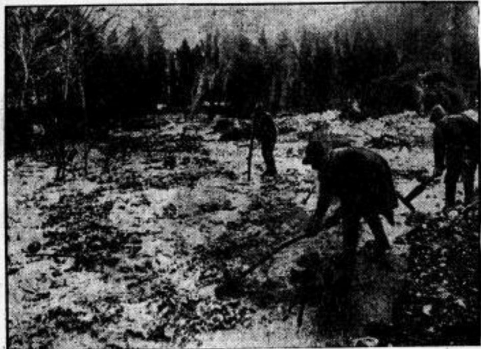
Zum Begrüßung am Inn. Unser Bild zeigt die Regulierungsarbeiten am Gassenbach, der durch Erdmassen vollständig verschüttet worden ist. Bei Oberaudorf sind die Erdbewegungen noch nicht zum Stillstand gekommen.
