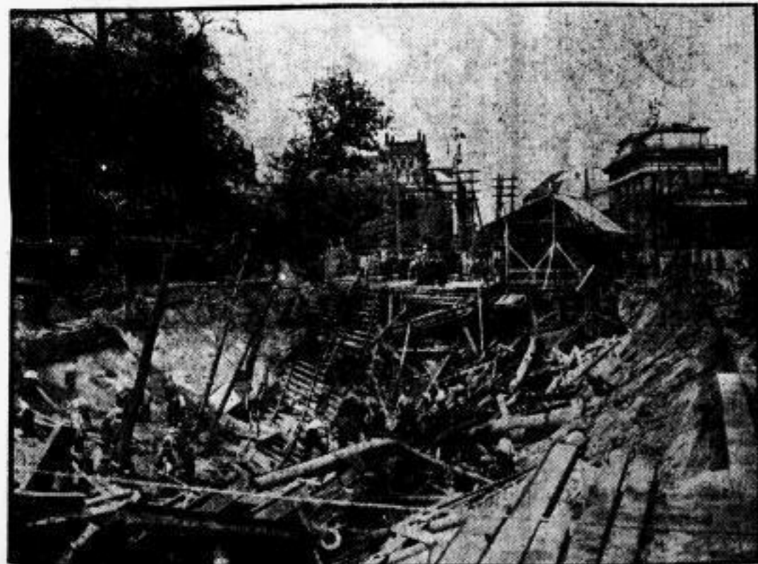
Blick auf die Einsturzstelle am Tunnelbau der Nord-Süd-S-Bahn in Berlin.
